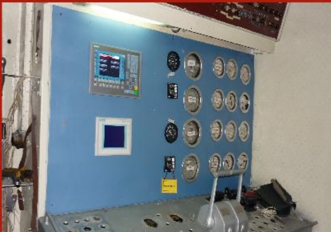
Sistema de supervisión instalado en el ARC quitasueño, en la foto se observa en el cuarto de maquinas un Multi-Panel Siemens.
