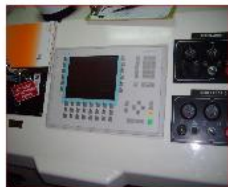
La comunicación se realiza entre PLC Siemens e interfaces de supervisión
